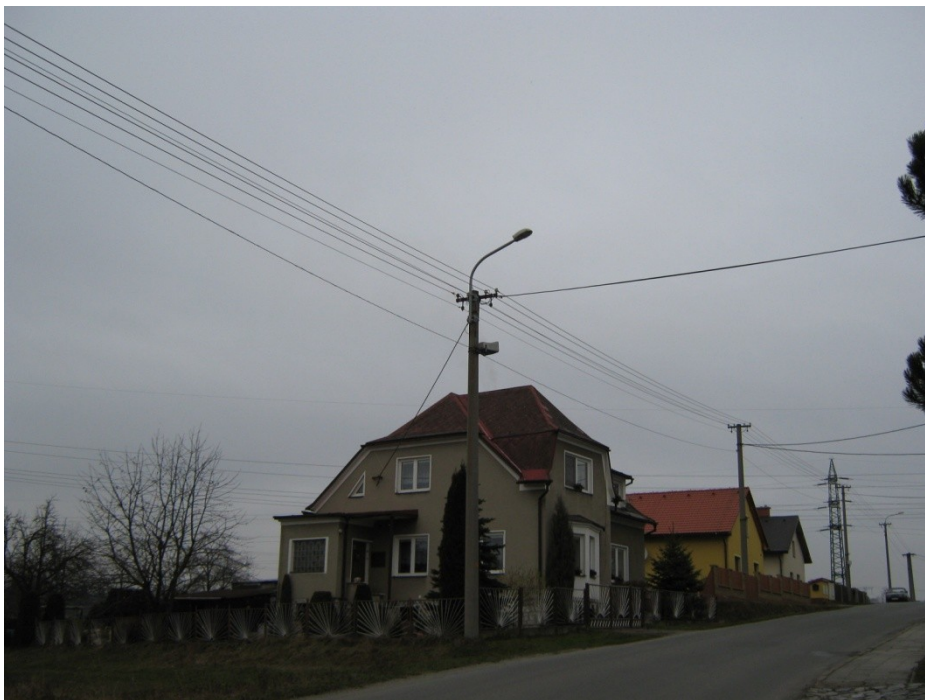
Osvětlení po rekonstrukci
